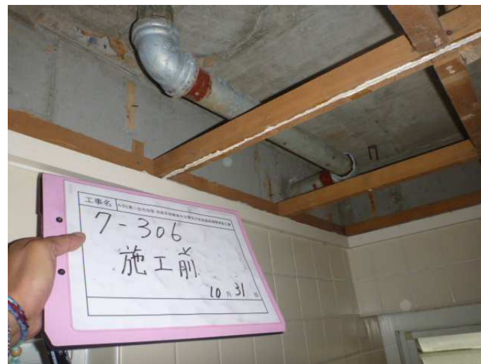
浴室旧排水管状況
